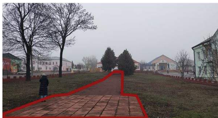
Отсутствие благоустройства. Устаревшее покрытие
